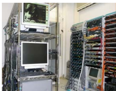
Sala de servidors de fitxers i d'aplicacions, i armari de comunicacions
